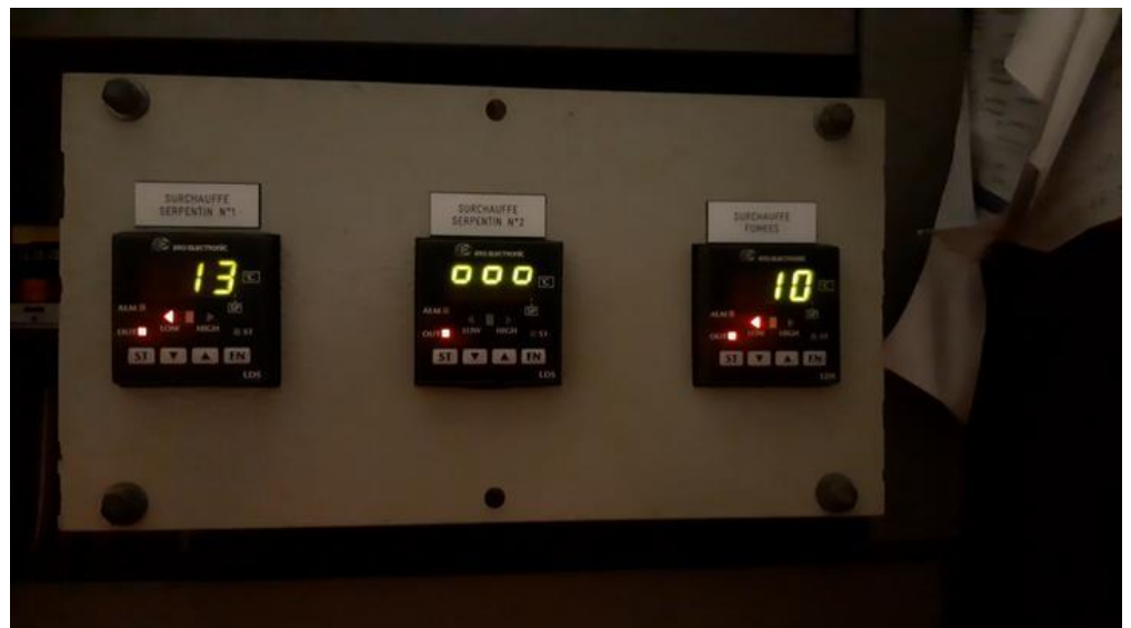
Transmetteur boucle de sécurité chaudière
