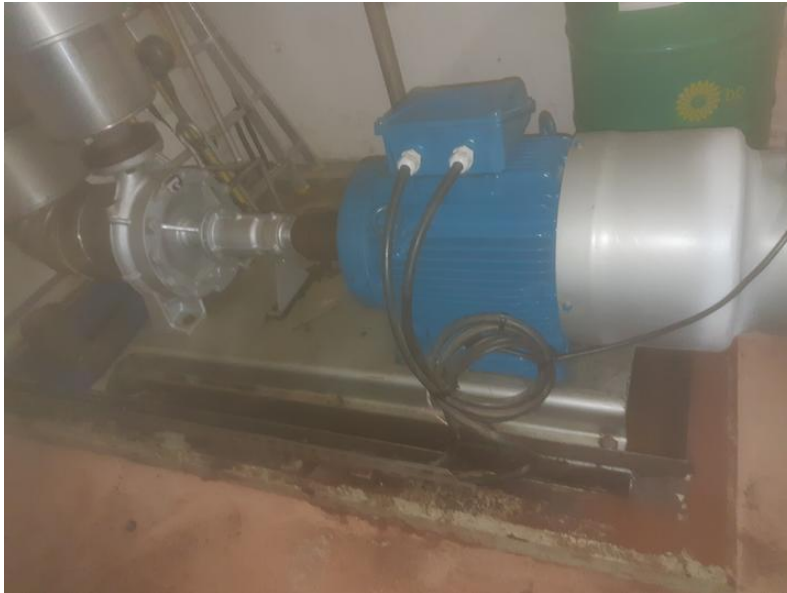
Moteur et pompe de la chaudière
