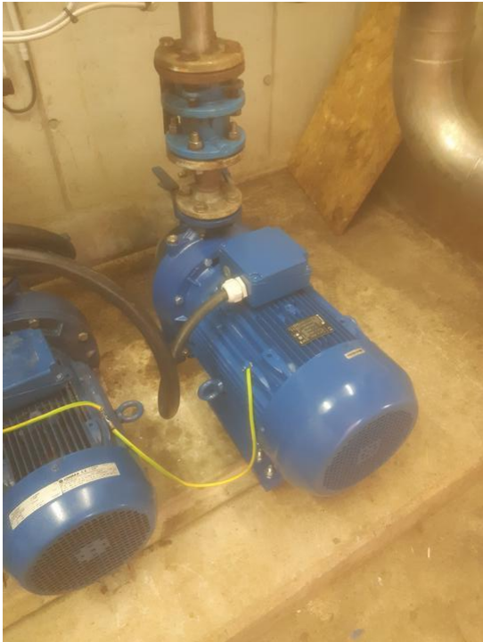
Pompe eau industrielle n°3 + variateur
